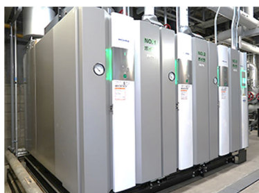
高効率ボイラー導入
